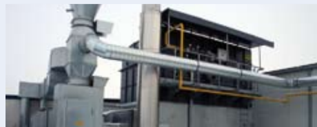
L'impianto di scarico dei prodotti di combustione sul tetto del nuovo edificio
