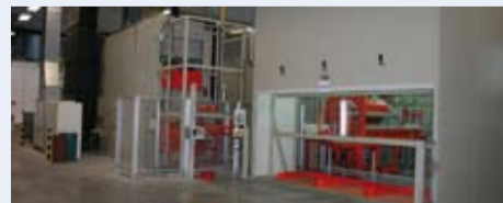
Il nuovo impianto per immersione-centrifugazione
